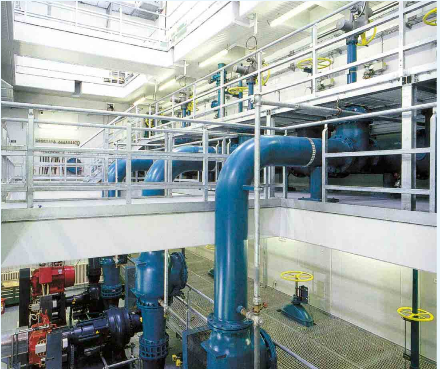
BERLINER WASSERBETRIEBE: moderne Pumpwerkstechnik
