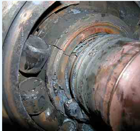
Schaden an einem Wellenlager
