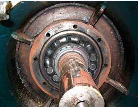
Wellenlager einer Abwasserpumpe
