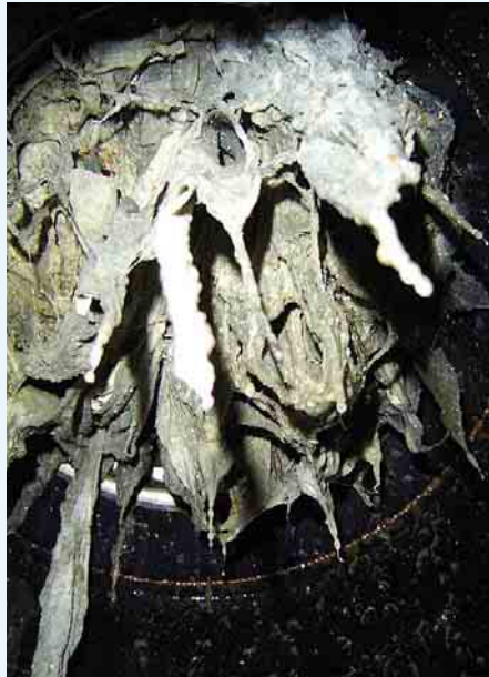
Laufradverstopfung einer Abwasserpumpe
