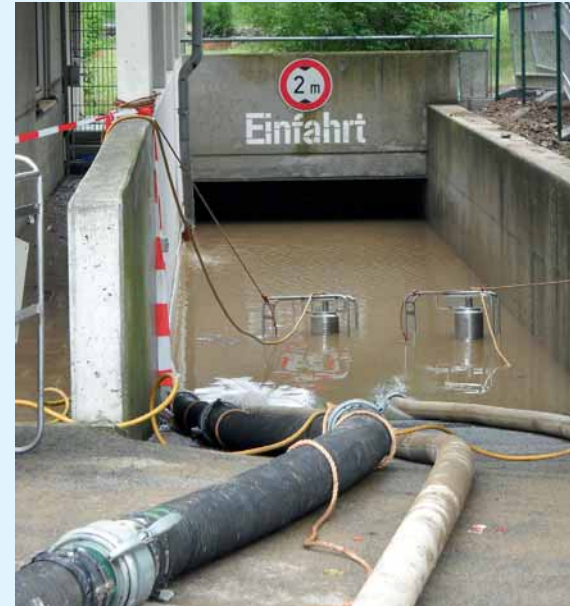
Plötzlicher Starkregen am frühen Sonntagmorgen, Überflutung einer Tiefgarage bei Stuttgart im Juli 2010
