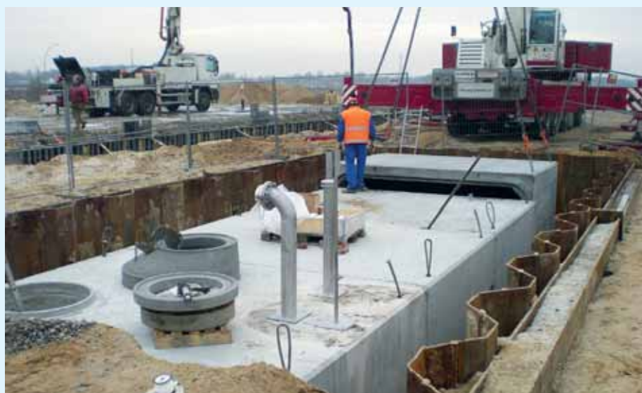
Entnahmestelle über einem der vier unterirdischen Löschwasserspeicher
