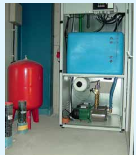
Regencenter Mall Tano XL, die Zentrale der Regenwassernutzung im Gebäude
