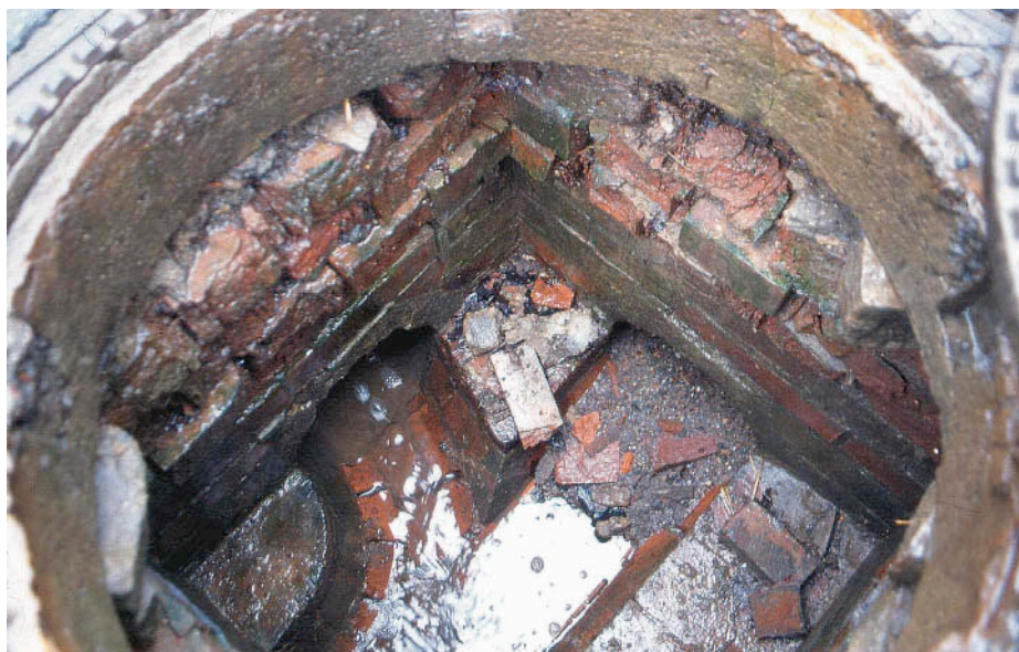
NICHT ZU VERGESSEN: Auch Schächte gehören zum Abwassernetz – und ihr Zustand ist keineswegs besser als der der Rohre.
