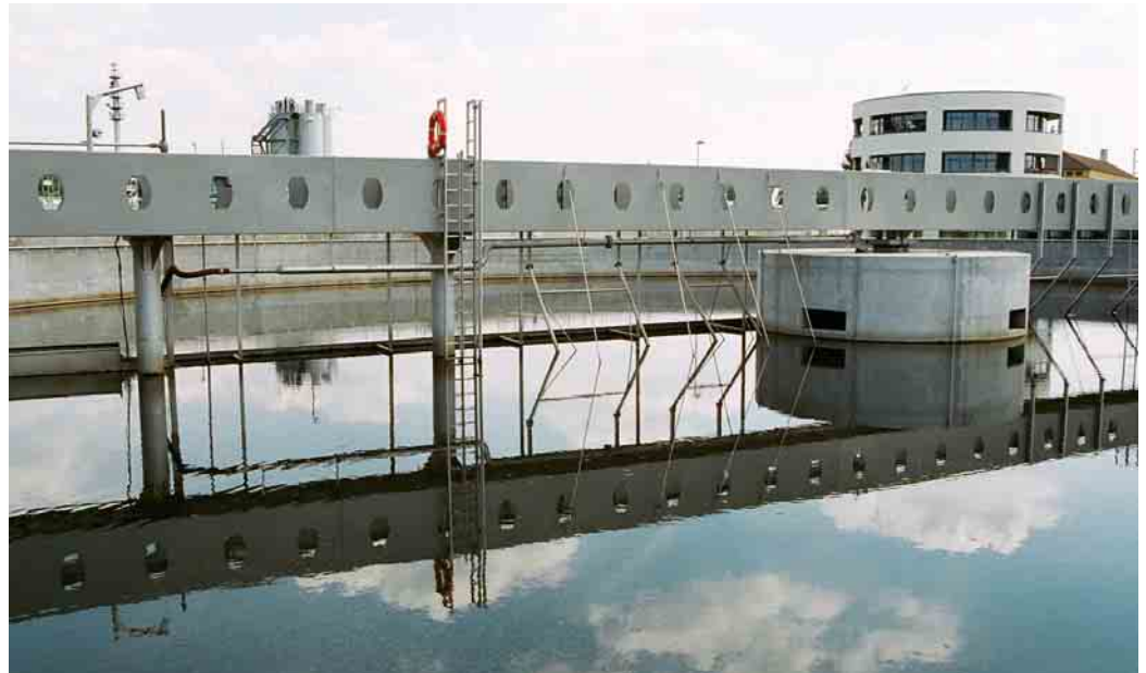
MODERNE TECHNIK: Kläranlage Dresden Kaditz
